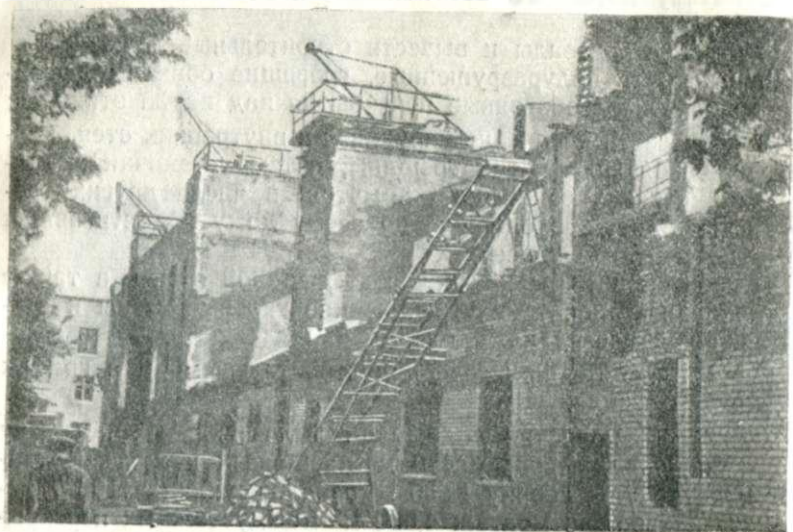
Рис. 49. Установка кранов Любимова и кранов ДИП на сохранившихся лестничных клетках при восстановлении дома
