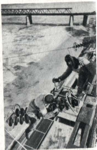
Подвеска гирлянды высокого напряжения первого агрегата Днепрогэса. Февраль 1947 года
